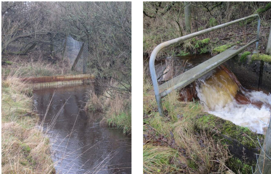
Foto 1 Tv. Vandindtag til Debel Fiskeri. Th. Stemmeværk til regulering af vandindtag til Debel Fiskeri. Der er tydelig tegn på okker påvirkning på betonkonstruktioner i stemmeværket.
