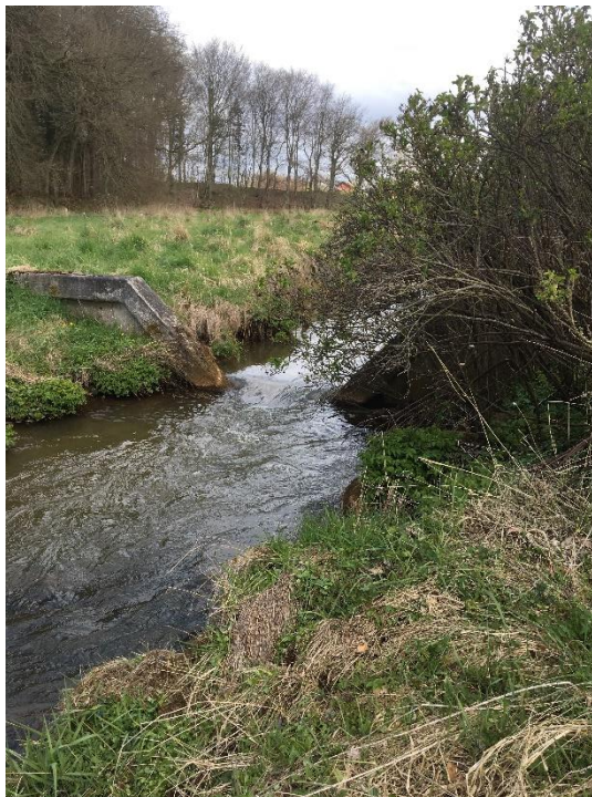
Figur 21. Styrt ved st. 7.480.
