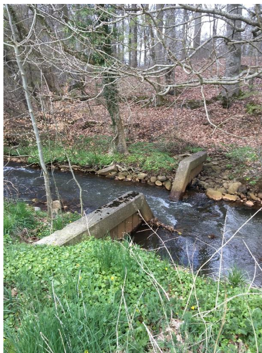
Figur 22. Styrt ved st. 7.993.
