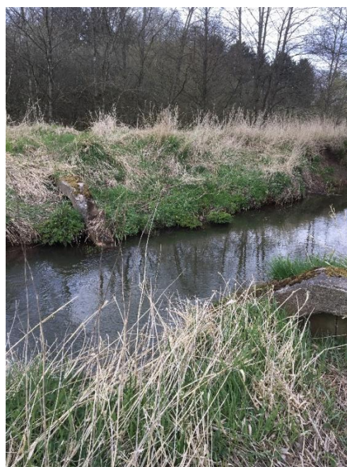
Figur 23. Styrt ved st. 9.869.
