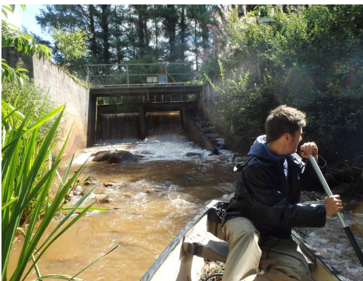
Figur 80: Stemmeværket ved Karlsgårde Dambrug.
