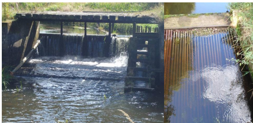
Figur 43: Stemmeværk ved Risbøl Dambrug og afgitring ved indtag.
