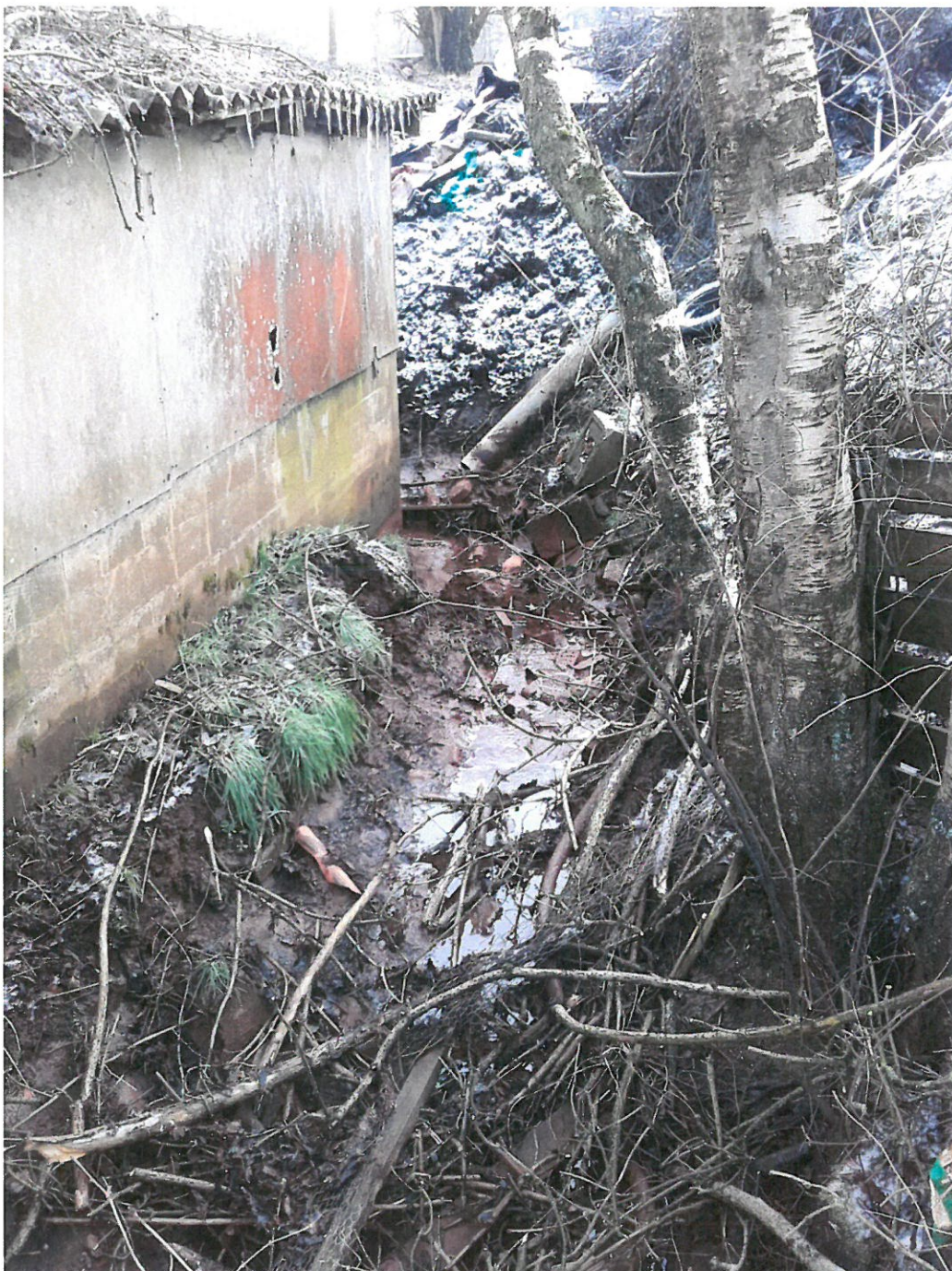
Figur 4. Billedet er fra nedstrøms stemmeværket bag klækkehuset. Fødekanalen er afskåret opstrøms stemmeværket. Der løber nu kun en minimal mængde banktrykvand gennem stemmeværket.
