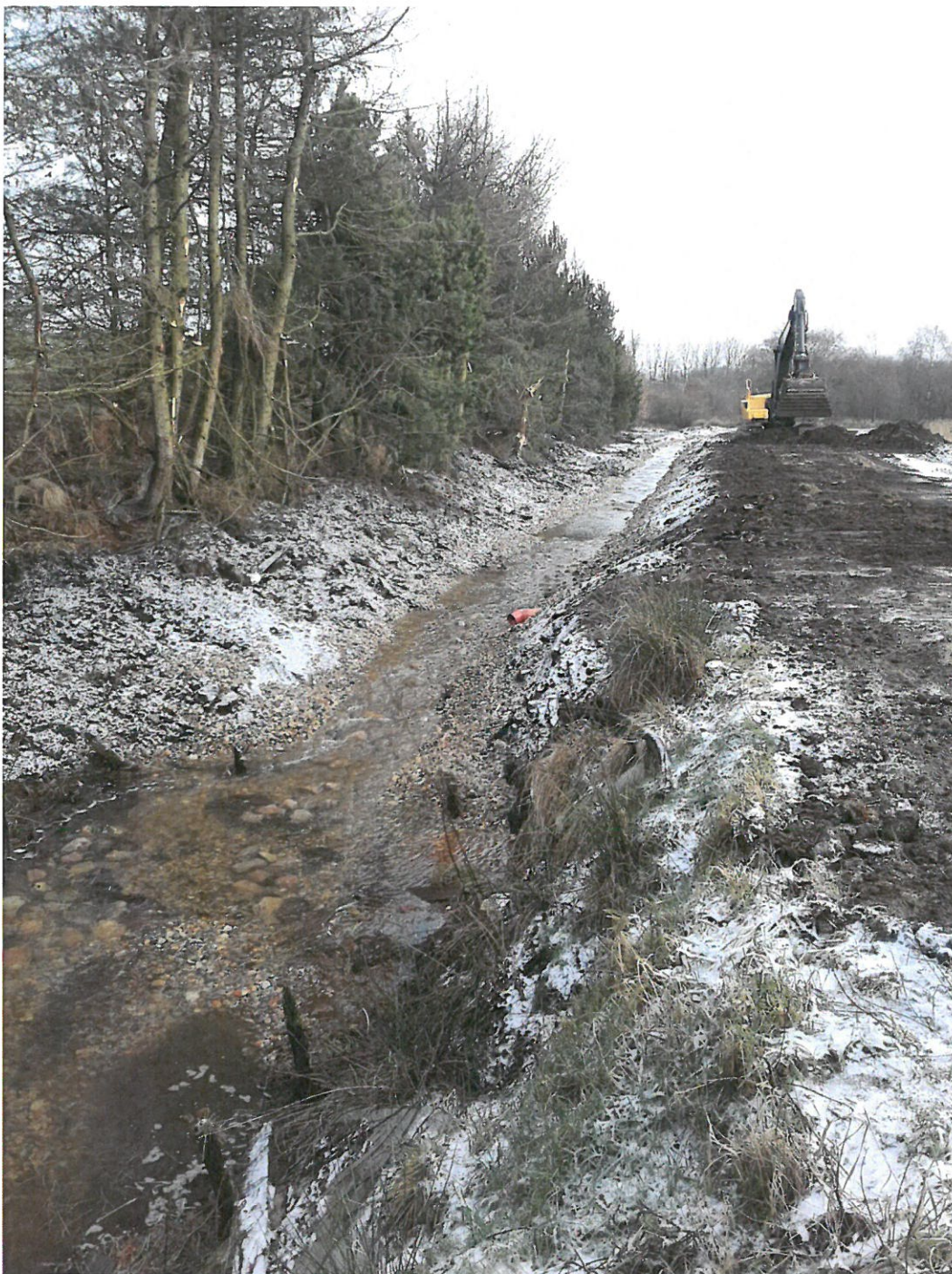
Figur 6. Nyt omløbsstryg anlagt i den gamle bagkanal. Set opstrøms fra indløb i det gamle bundfældningsbassin.
