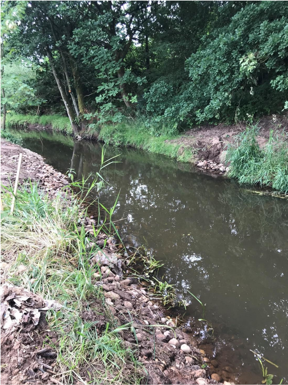
Figur 3. S6 efter nedbrydning af betonstyrtet og udlagt grusstryg. Stenmateriale fra nedstrøms betonstyrtet er genanvendt som skjulesten og ellers aflagt langs især venstre brink. Der er grødestuvning af vandet fra den nedstrøms strækning.
