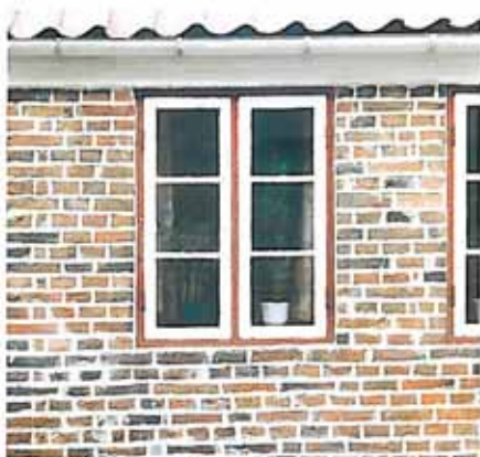
Torammet vindue med trerudedede rammer.
