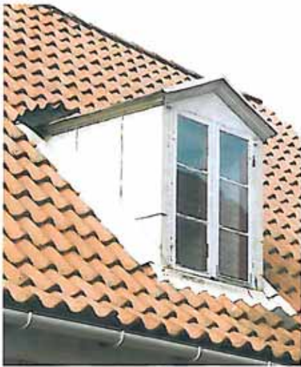
Ældre tagkvist med zinkdækkede sider (flunker) og tag samt en lille profileret gesims under tagdhængen.
