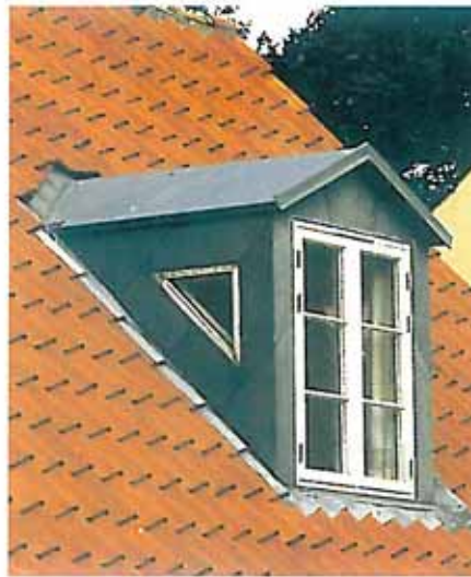
Ny tagkvist med zinkdækkede sider (flunker) og tag. Bemærk flunkernes beskedne tykkelse, der svarer til forholdene på den ældre tagkvist t.v. Hvis flunketykkelsen øges, kommer kvisten til at se "tykkindet" og klodset ud.
