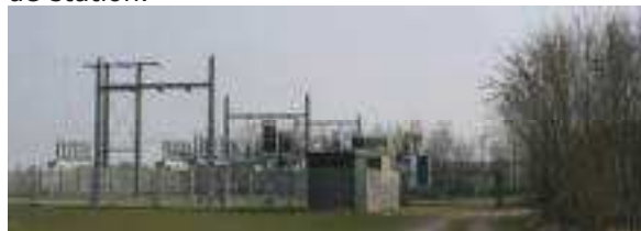
Figur 7.2-52 Transformatorstation. Teknikbygning ligger bag bevoksning i billedets højre side. Foto fra Nørhede ved Ringkøbing.
