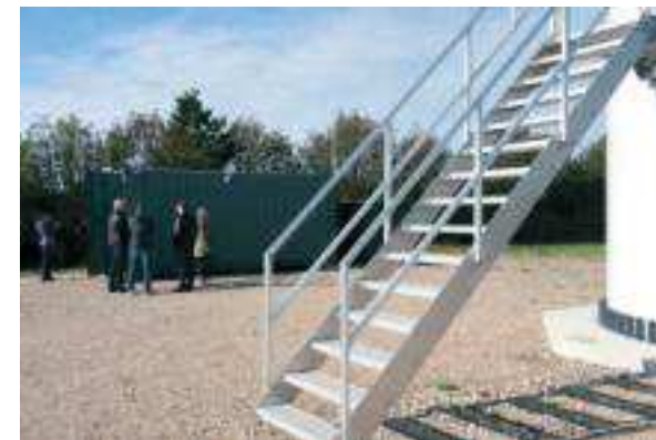
Figur 7.2-53 SCADA-anlæg ved vindmølle. Til højre for SCADA-anlægget bag trappen til vindmøllen, skimter man en koblingsstation.
