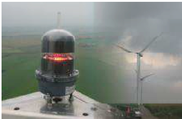
Figur 7.2-51 Lysafmærkning for flysikkerhed.
