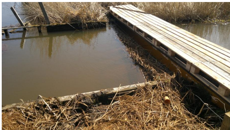
Fig. 5. Vandindtaget til dambruget er ca. 4 m bredt. Bunden lå ca. 1 m under vandspejl ved en besigtigelse d. 24. april 2013.
