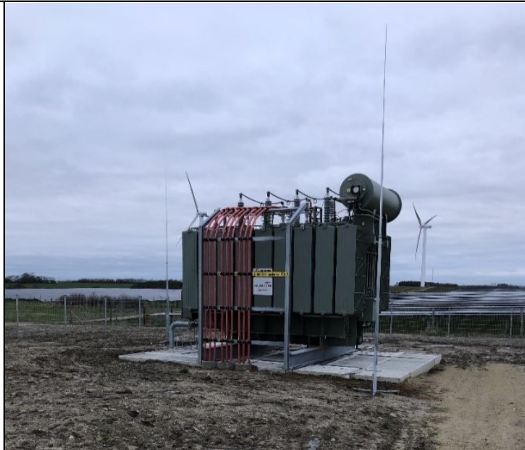
Foto - Eksempel på 60 kV effekttransformer og lynafledere
