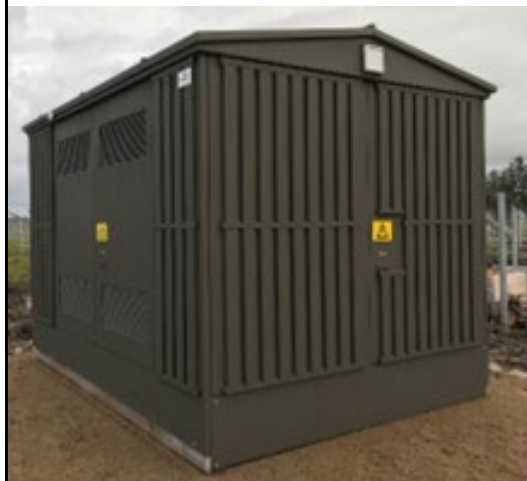
Foto – Eksempel på transformerkiosk
