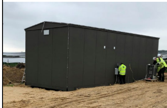
Foto - Eksempel på primær koblingsstation
