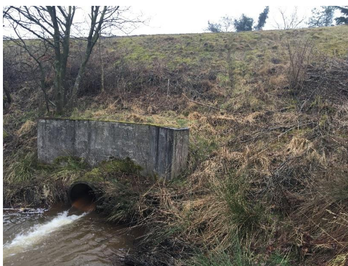
Figur 2 Spærring ved jernbane
