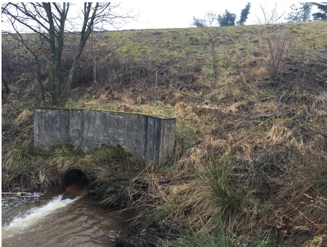
Figur 5. Spærring RIB-02018x, udløb af rørunderføring ved Jernbanen syd for Sig (20. februar 2018).
