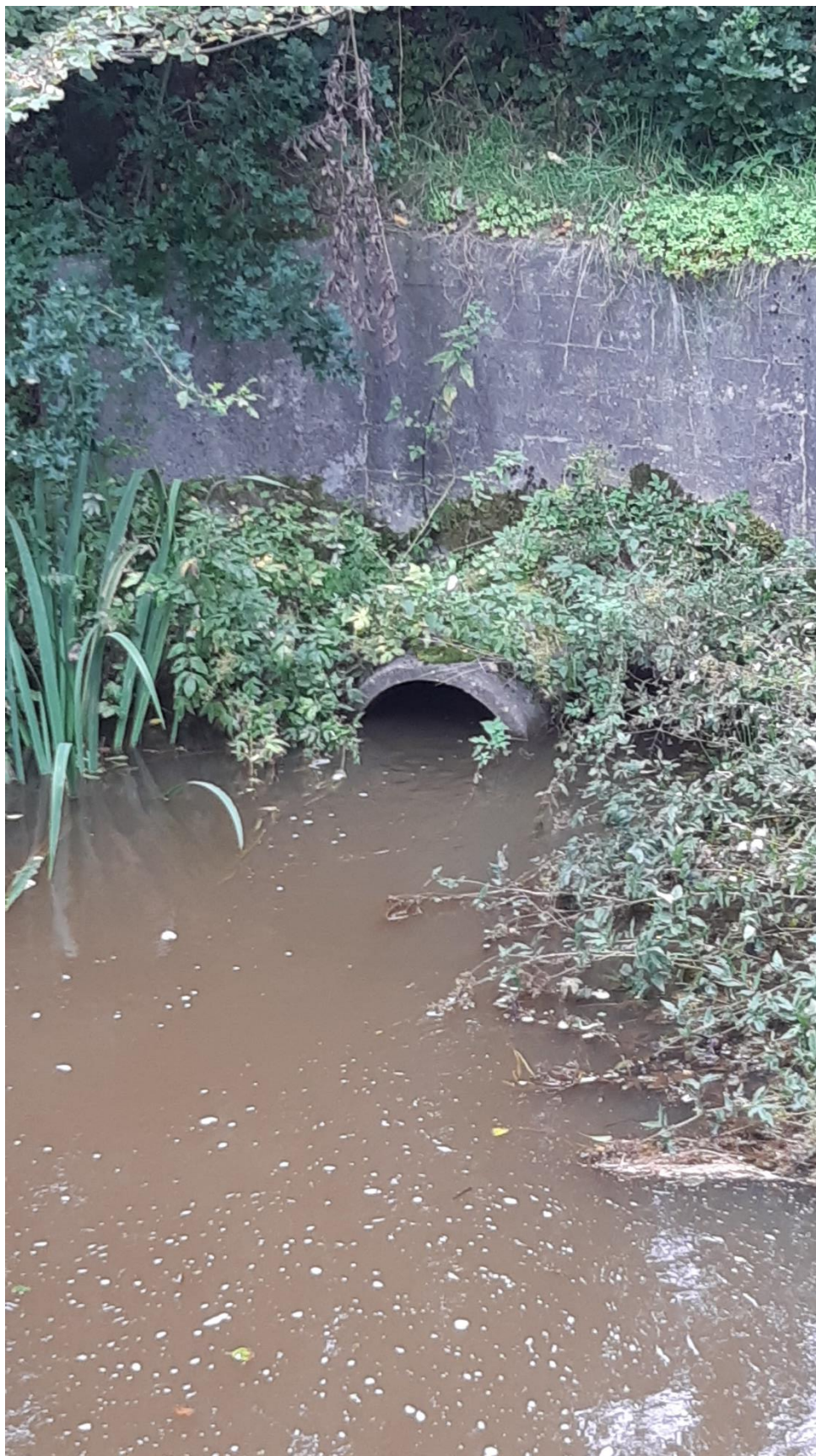
Figur 10 Hævet vandspejl i rør ved passage under jernbanen.
