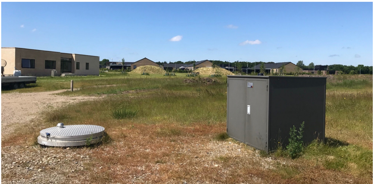
Figur 4. Foto af nyligt etableret pumpestation med kombineret el- og ventilskab, som forventes anvendt i nærværende projekt.
