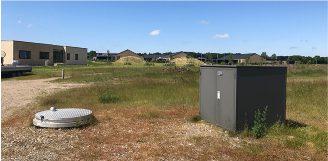
Figur 2.6: Foto af nyligt etableret pumpestation med kombineret el- og ventilskab, som forventes anvendt i nærværende projekt. DIN Forsyning har fået foretaget en miljøscreening af de bygninger og bygværker, som fjernes i forbindelse med ombygningen. Der er således et solidt grundlag for at separere materialerne i forbindelse med nedrivning korrekt og bortskaffe disse i henhold til gældende regler.
