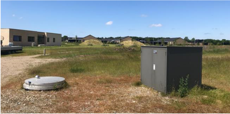
Figur 2 Foto af nyligt etableret pumpestation med kombineret el- og ventilskab, som forventes anvendt i det beskrevne projekt.
