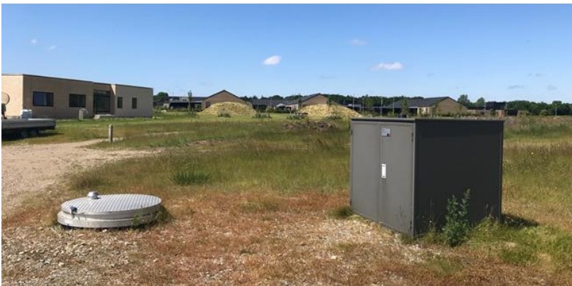
Figur 2 Foto af nyligt etableret pumpestation med kombineret el- og ventilskab, som forventes anvendt i det beskrevne projekt.
