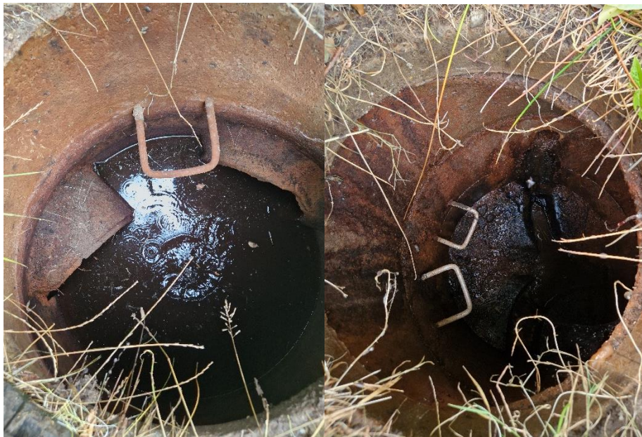
Figur 3 Brønde ved Gl. Mælkevej uden dæksel, de på nordsiden er der vand i, den på Sydsiden står tom for vand.
