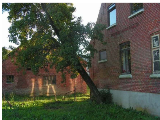
Figur 1. Udtørringsskadede gavle på fedt ler. Revnerne er svære at få øje på – men ikke skadevolderen.
