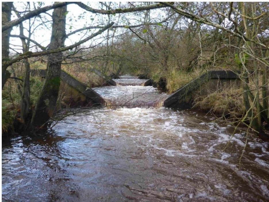
Figur 3. Betonstyrte ved spærring RIB-01123
