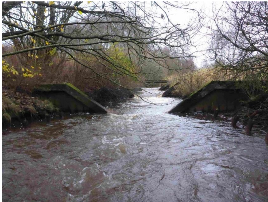
Figur 2. Betonstyrte ved spærring RIB-01122
