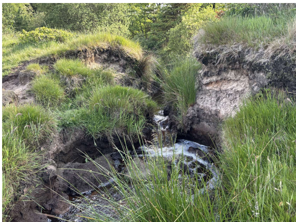
Figur 4. Bruddet, hvor vandet fra Vestre Landkanal løber igennem Ringdiget og ind i Petersholm Inddæmningen, set i juni 2025.
