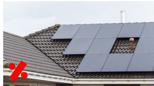
Figur 18. Eksempler på solcelleanlæg, som virer skæmmende, da de ikke er placeret harmonisk, integreret i tagfladen hverken teknisk eller farvemæssigt.
