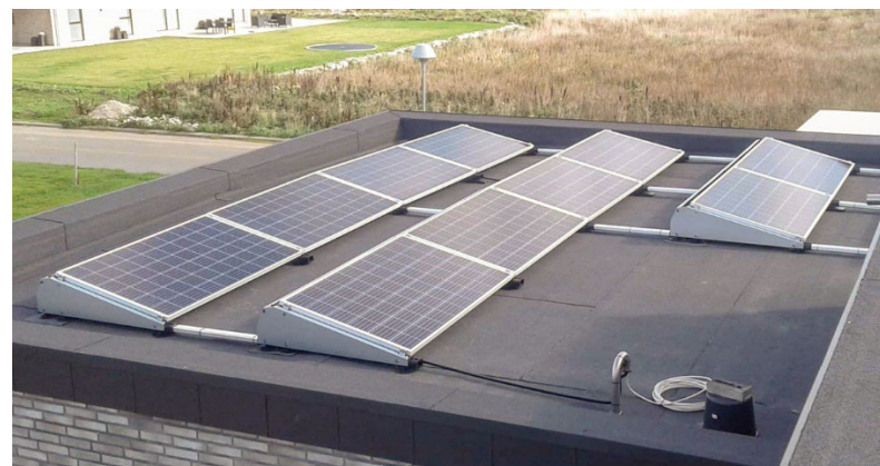
Figur 19. Eksempel på vinklet solcelleanlæg på fladt tag hvor facade (i dette tilfælde murkron) skjuler anlægget.
